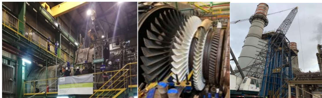
Turbina de gas de la unidad TG04 y Caldera HRSG 12
