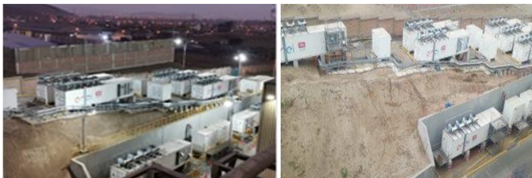
Foto: Sistema de baterías (BESS) Ventanilla
