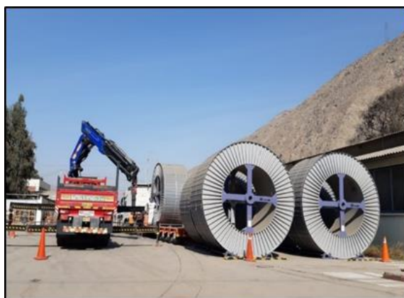
Recepción de cables en la Central Huinco
