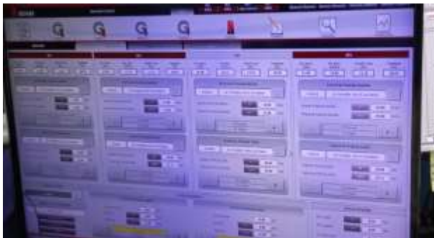
SCADA 3 de Huinco con el despliegue de potencia de la generación.
