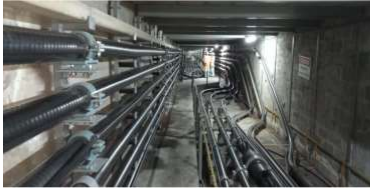
Cables de 220kV de la Central Huinco.
