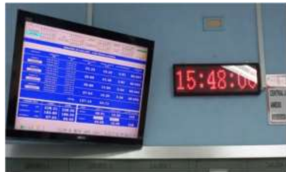
SCADA de Huinco y sus monitores gráficos.
